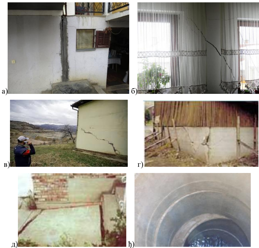
Слика 16. Знакови клизишта у насељу: а), б), в), г) пукотине на зидовима објеката, д) пукотине на тротоару, е) деформисан (померен бунар)
